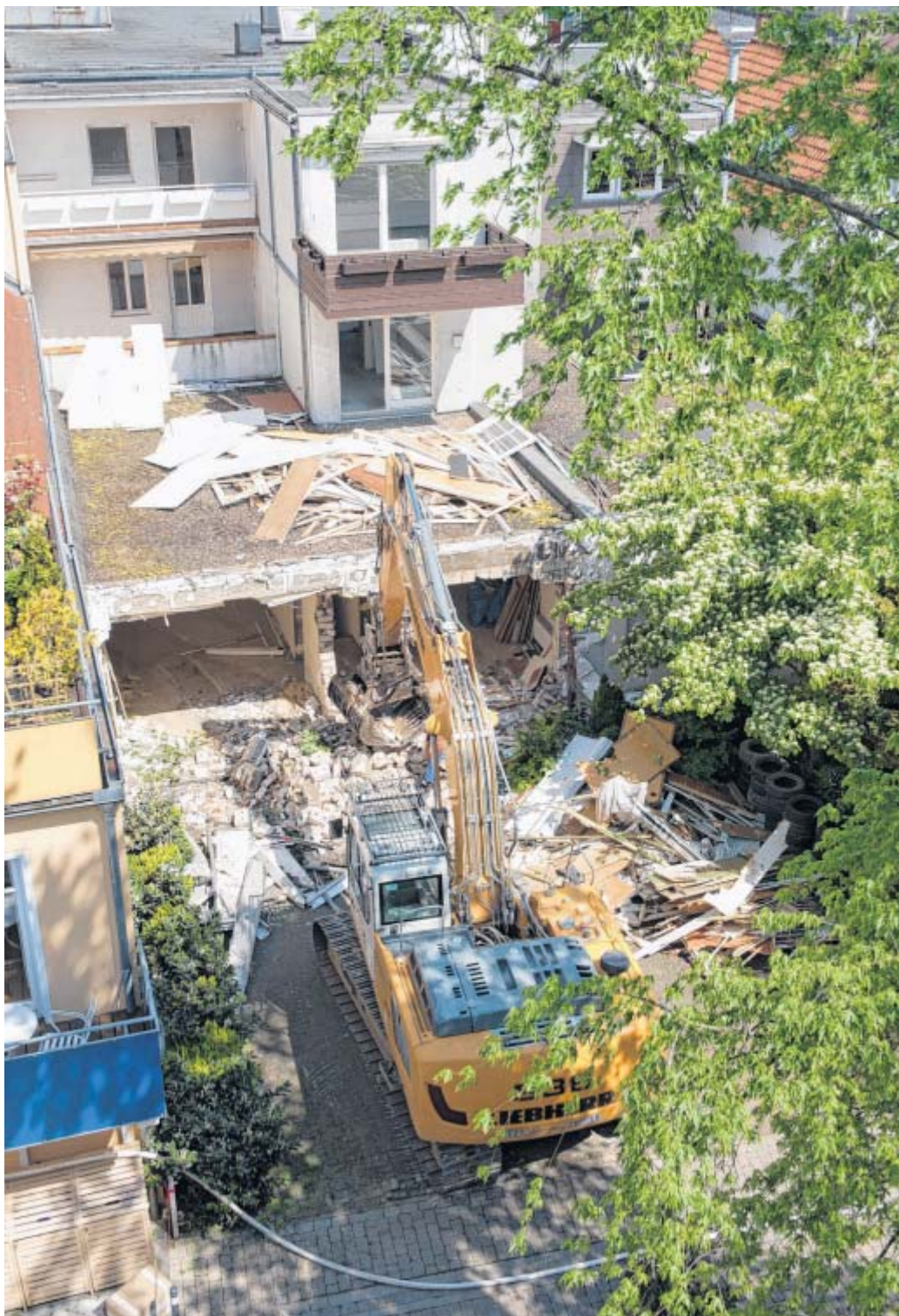
Blick vom Parkhaus: Langsam arbeitet sich der Bagger von hinten in Richtung Fußgängerzone. Der anfallende Schutt soll später als Rampe für den Bagger dienen. FOTOS (2): RALF BITTNER
